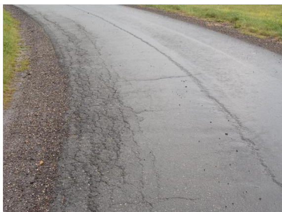
Foto 4: Schade door zwaar en breed (landbouw-)verkeer
