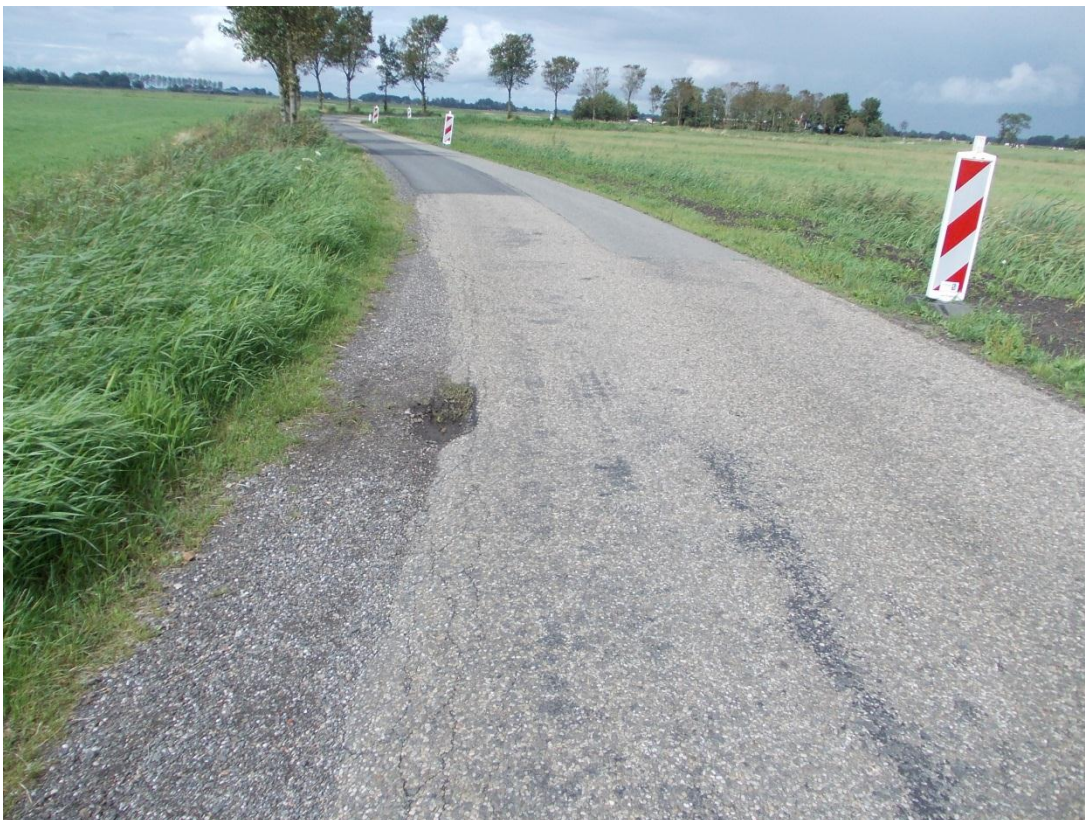
Foto 21: Reparatie en schade wisselen elkaar af
